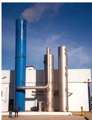
Prozesstürme im Aussenbereich
